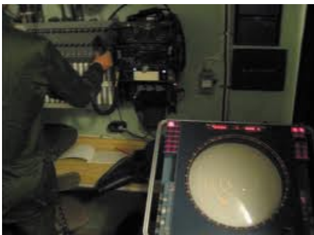
NSRR i maskinhuset.
